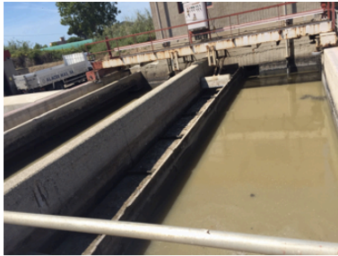
Figura II.1. Pretratamiento del agua residual
